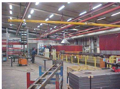
Ny lysrörsarmatur i stolphallen
